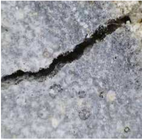
AQUAFIX uygulanmamış beton kırış (0,5 mm çatlak)
